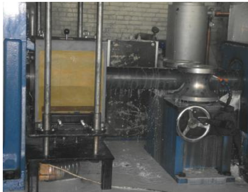
Рисунок 4 – Внешний вид блока преобразователей на трубном стане.
