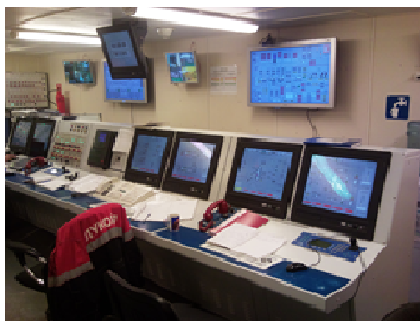
Станция оператора и обслуживания (ЧМИ)
