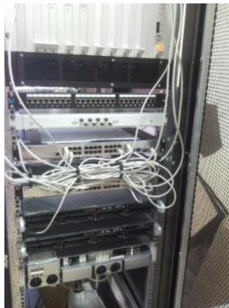
Рисунок 2 - Общий вид оборудования с открытой дверью
