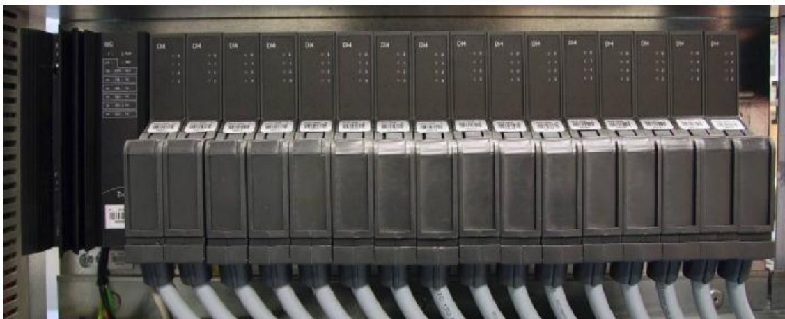
Рисунок 2 – Фото общего вида комплексов в электротехническом шкафу
