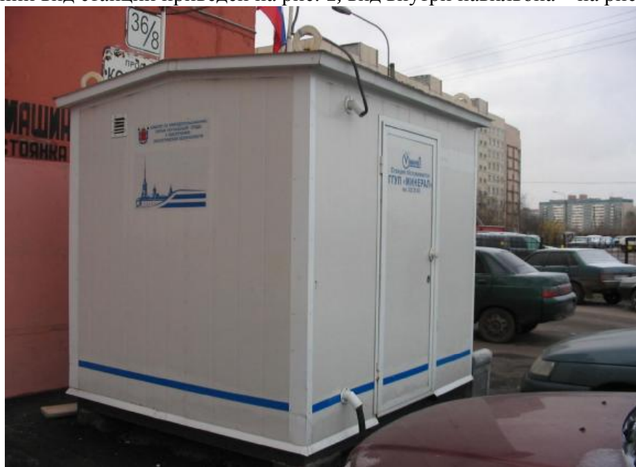
Рисунок 1 – Внешний вид станции УС-КВ-1
