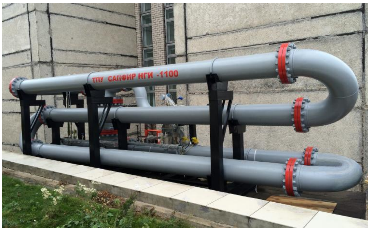
Рисунок 1 - Общий вид установки поверочной трубопоршневой Сапфир НГИ-1100
