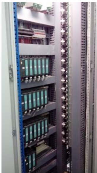
б) модули ввода/вывода в шкафу системы
