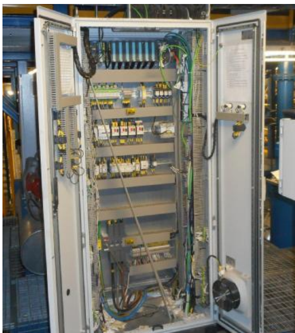
Рисунок 1 - Внешний вид контроллерного шкафа
