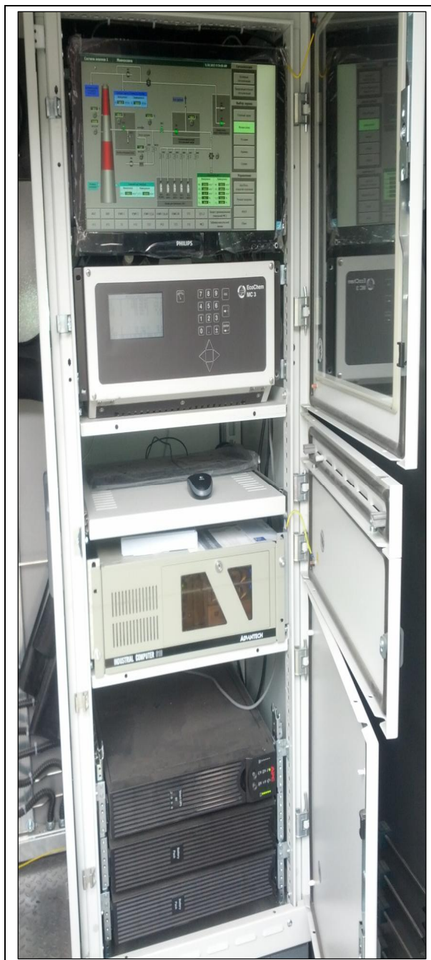
Рисунок 4 - Внешний вид шкафа с элементами системы
