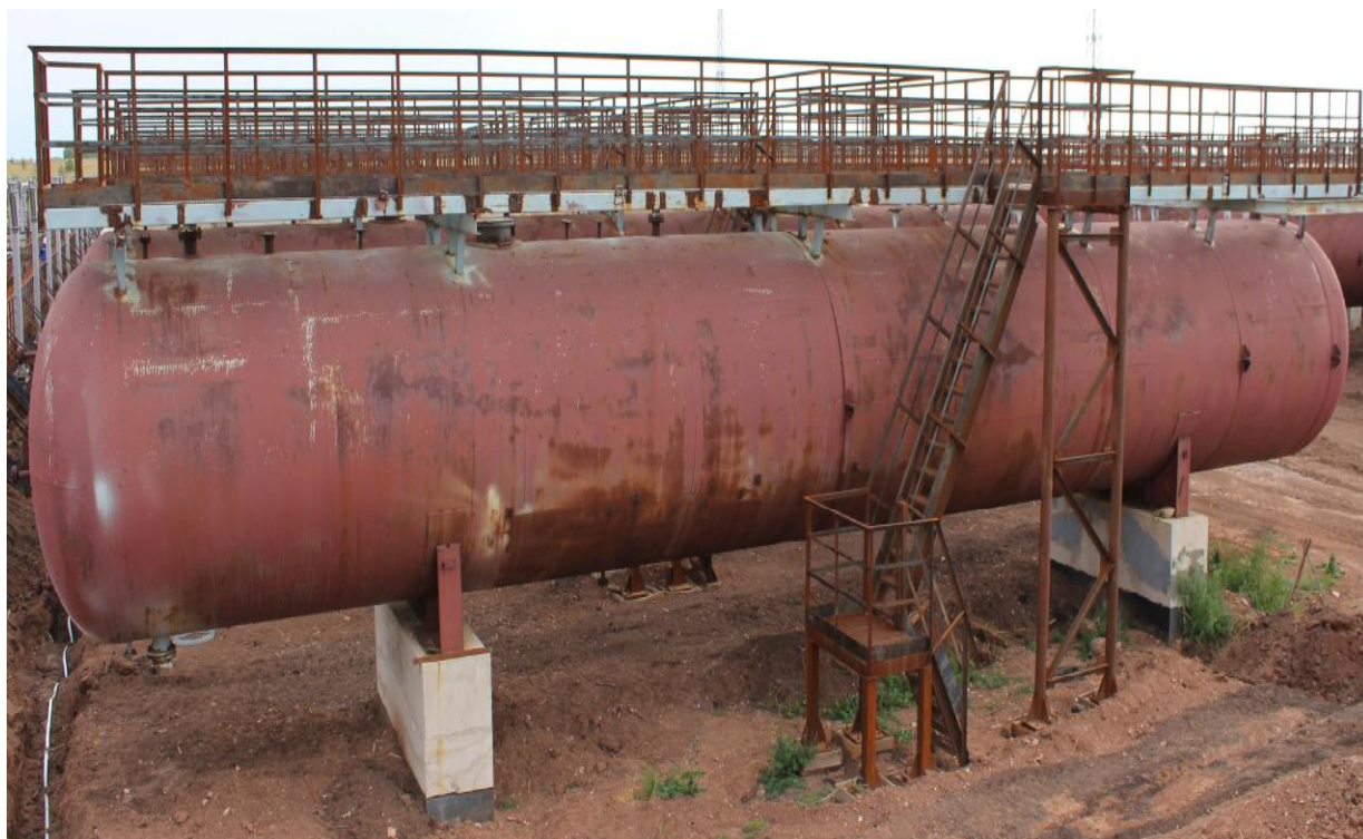
Рисунок 1 – Общий вид резервуара стального горизонтального цилиндрического ПС-200
