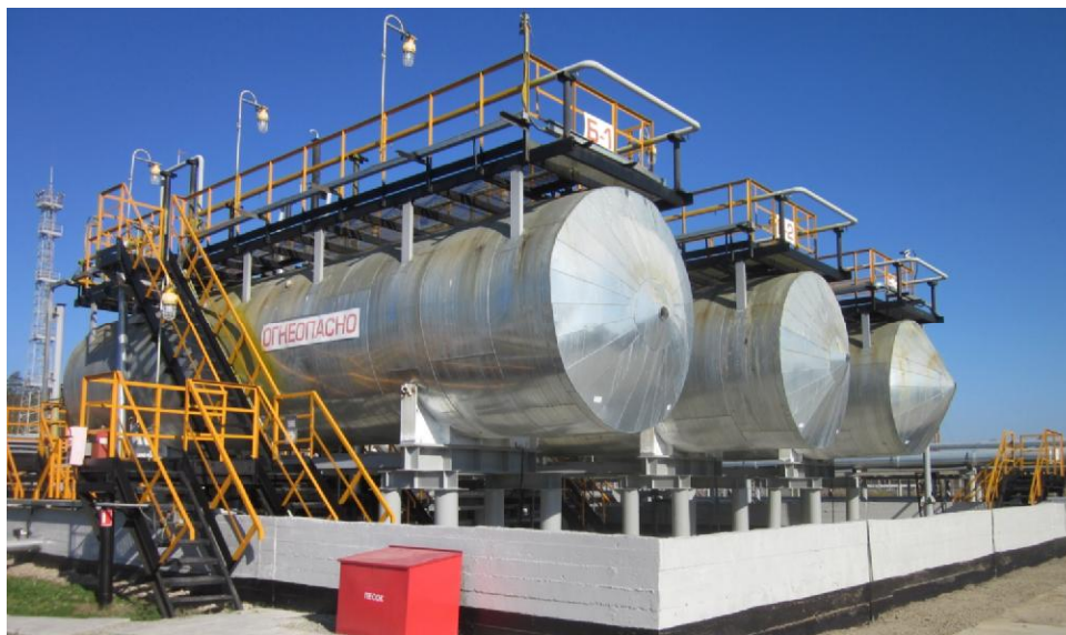
Рисунок 1 – Общий вид резервуаров горизонтальных стальных цилиндрических РГС-100
