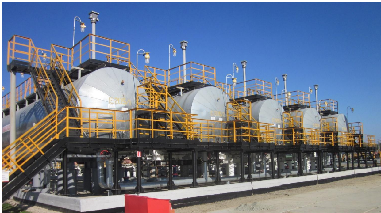
Рисунок 2 – Общий вид резервуаров горизонтальных стальных цилиндрических РГС-200
