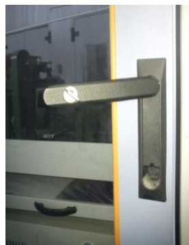
Рисунок 8 - Внешний вид замка на дверце стойки управления
