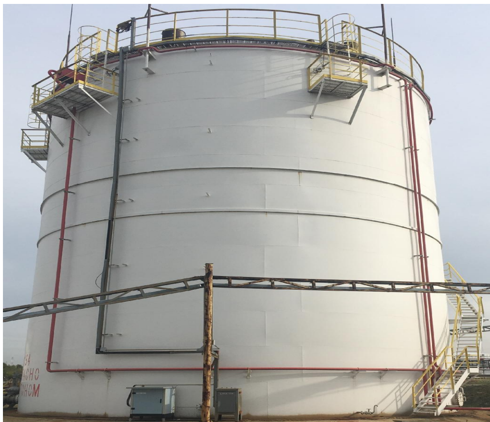
Рисунок 2 - Общий вид резервуара стального вертикального цилиндрического РВСП-3000
