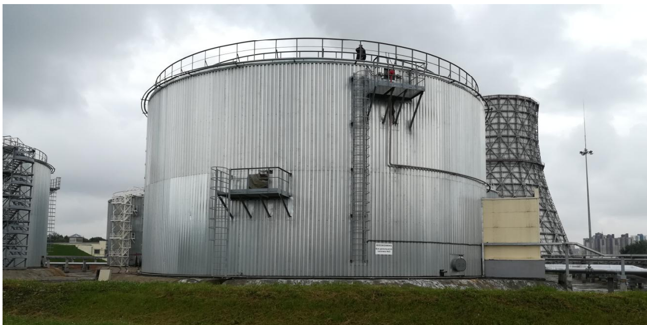
Рисунок 1 - Общий вид резервуаров вертикальных стальных РВС-5000
