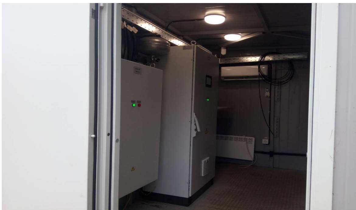
Рисунок 2 – Вид внутри контейнера
