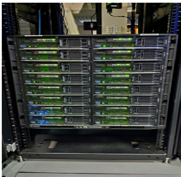
Рисунок 1 – Внешний вид шкафа
