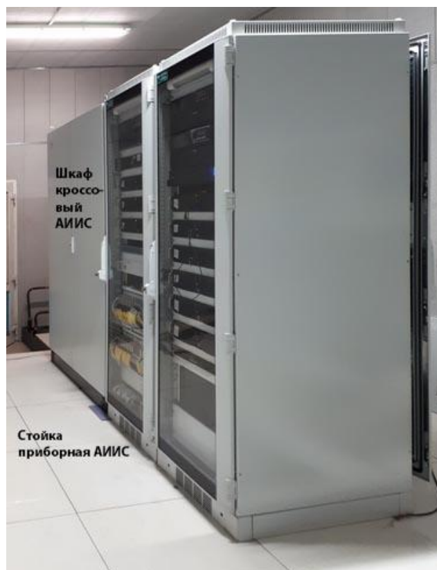
Рисунок 2 – Стойки и шкафы АИИС. Вид внешний
