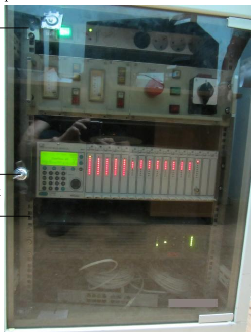
Рисунок 4 – Стойка с модулями для измерений линейных перемещений
