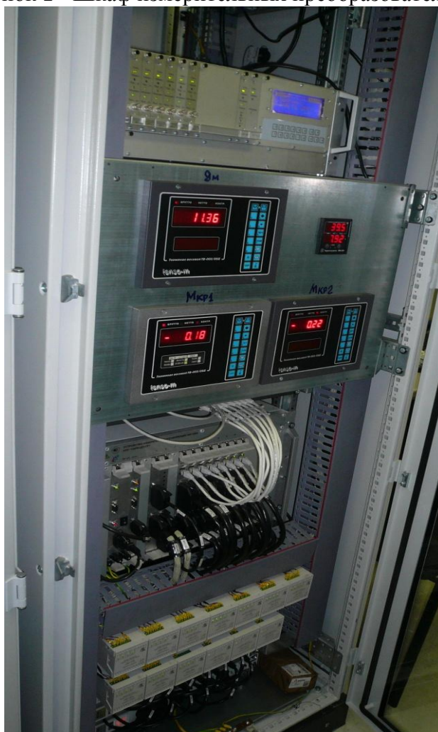
Рисунок 2 - Шкаф измерительного оборудования
