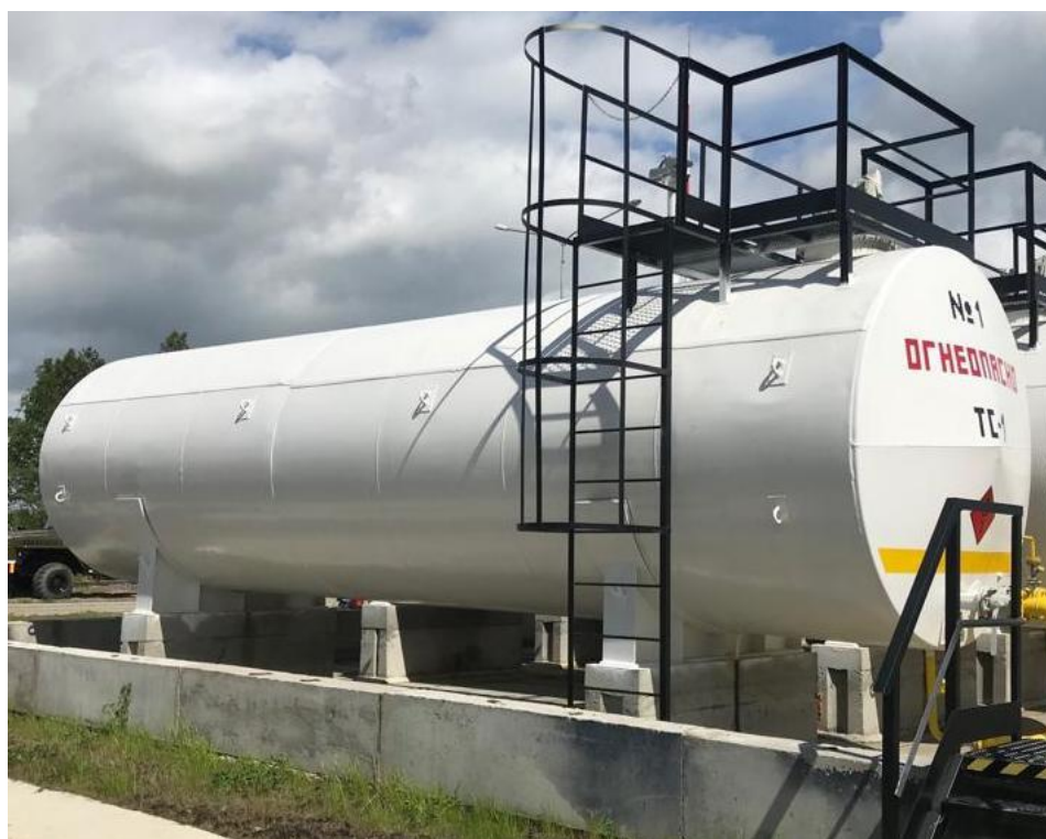
Рисунок 3 - Общий вид резервуаров стальных горизонтальных цилиндрических РГС-60
