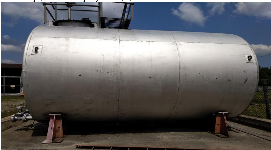
Рисунок 1 – Общий вид резервуаров стальных горизонтальных цилиндрических РГС-25
