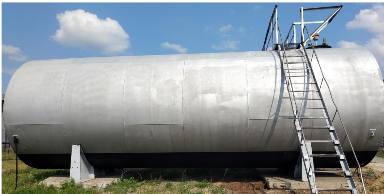
Рисунок 2 – Общий вид резервуаров стальных горизонтальных цилиндрических РГС-50
