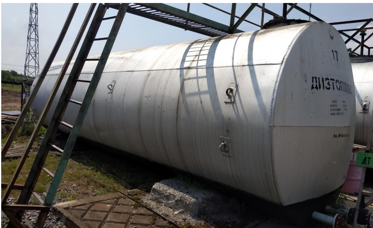
Рисунок 3 – Общий вид резервуаров стальных горизонтальных цилиндрических РГС-75
