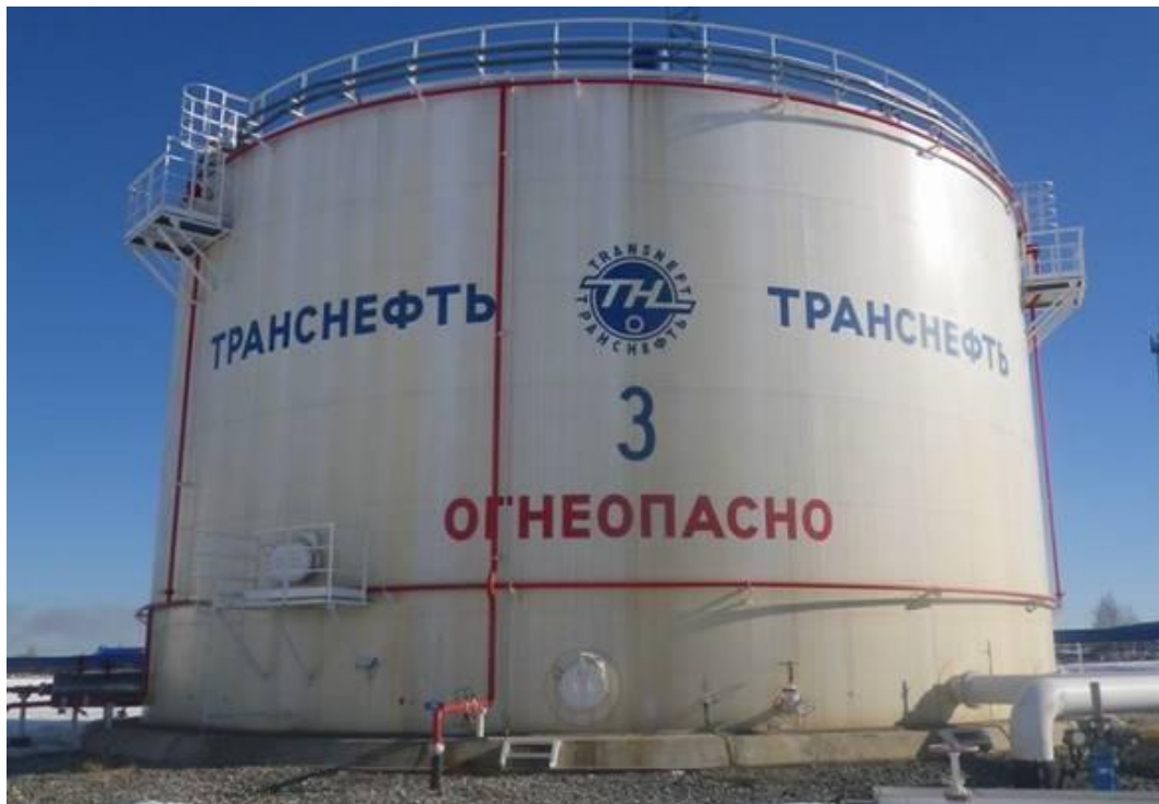
Рисунок 1 –Резервуар стальной вертикальный цилиндрический РВСП-5000
