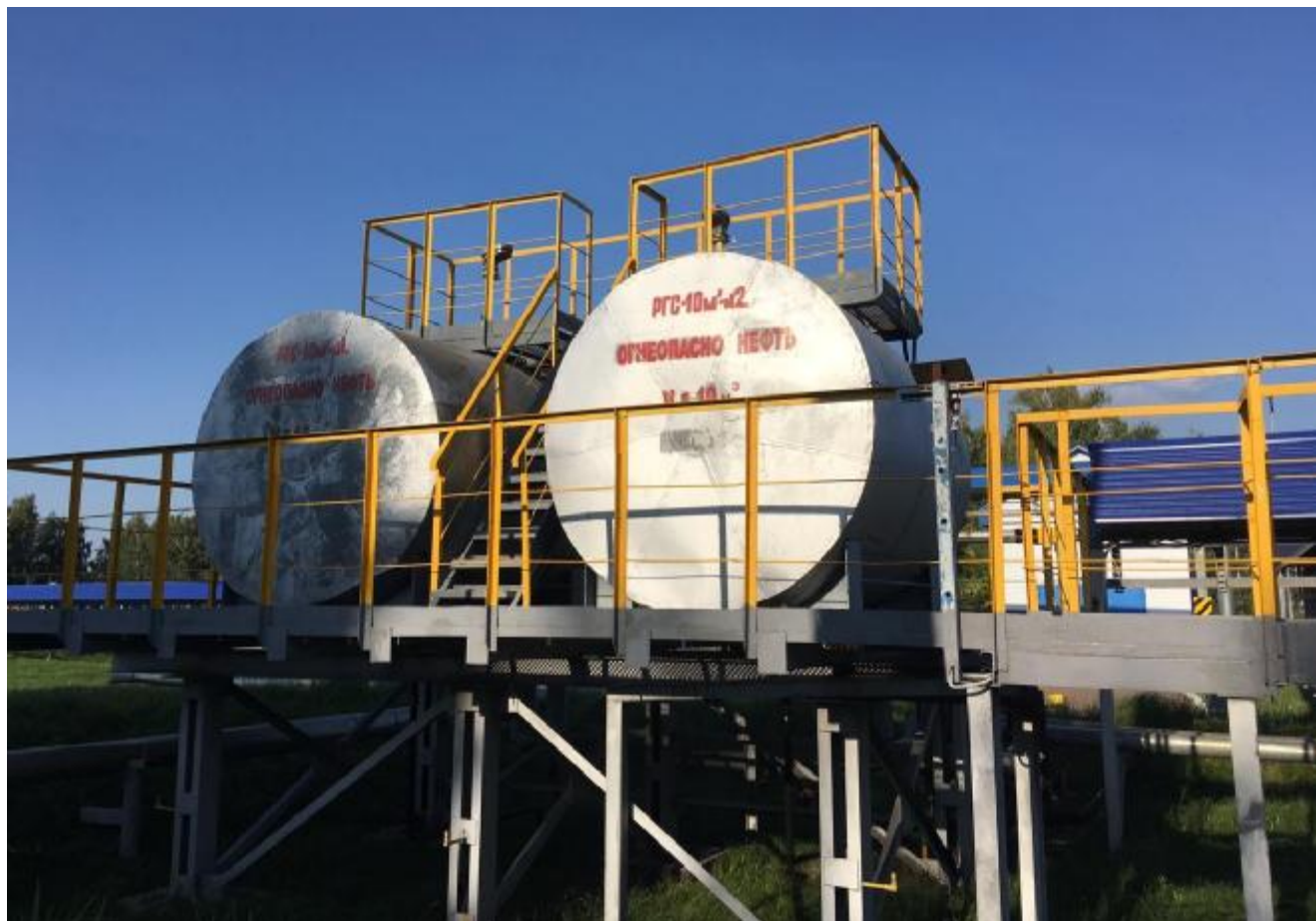
Рисунок 1 – Общий вид резервуаров стальных горизонтальных цилиндрических РГС-10
