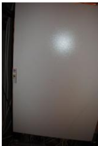
Рисунок 3 – Шкаф термостанции АИИС
