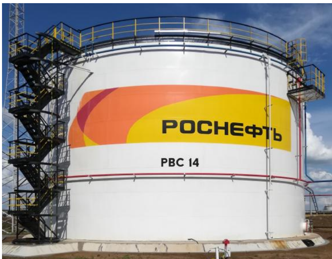
Рисунок 2 – Общий вид резервуаров стальных вертикальных цилиндрических PBC-5000
