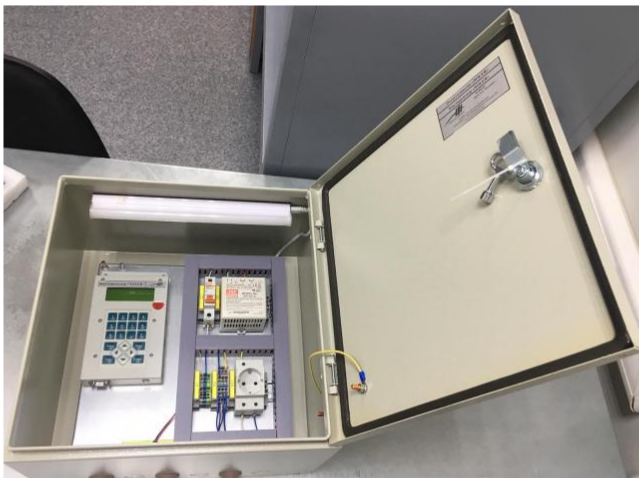
а) Измерительный модуль кислородомера в монтажном шкафу
