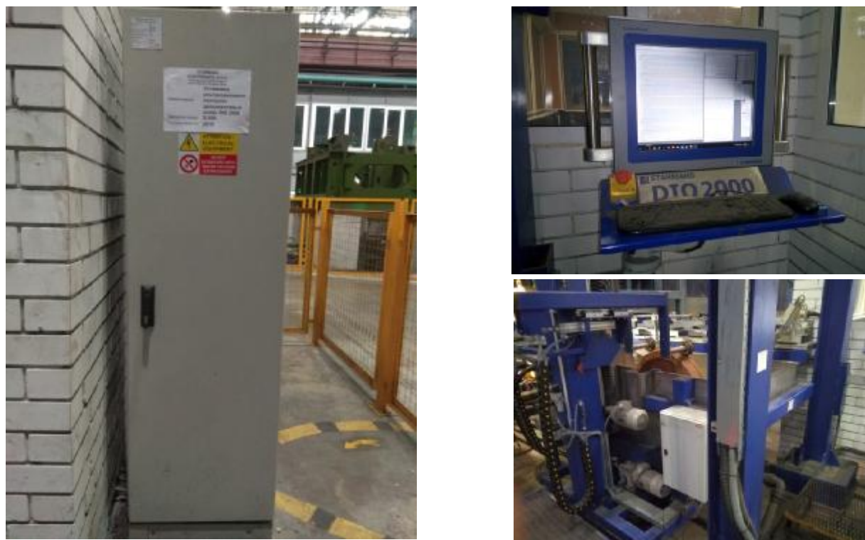
Рисунок 1 – Общий вид установки
