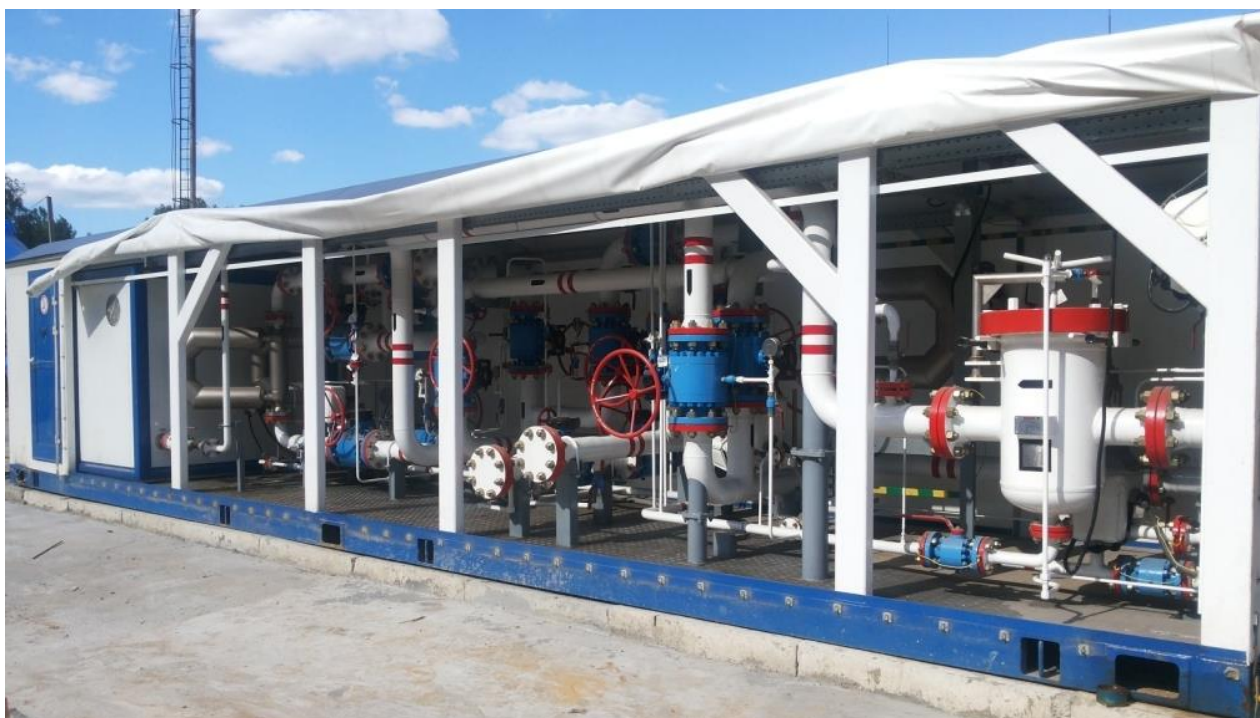
Рисунок 1 – Общий вид СИКН
