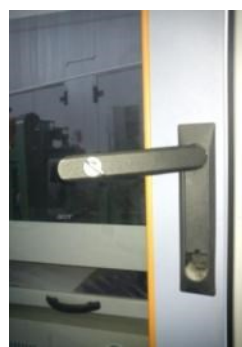
Рисунок 13 – Внешний вид замка на дверце стойки управления
