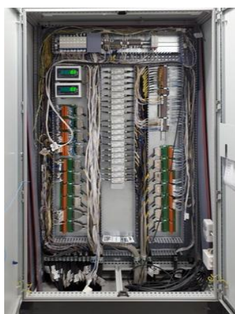
Рисунок 3 – Шкаф кроссовый АИИС. Расположение элементов. Вид внешний
