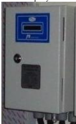
а) вычислитель, установленный в шкафу
