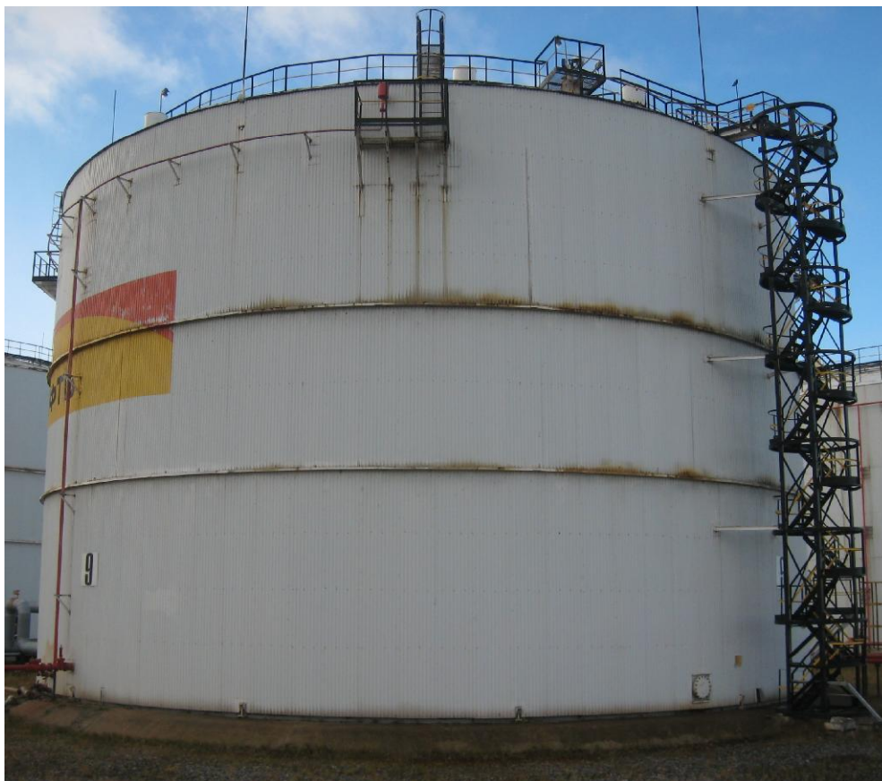
Рисунок 1 - Общий вид резервуара стального вертикального цилиндрического РВСП-10000
