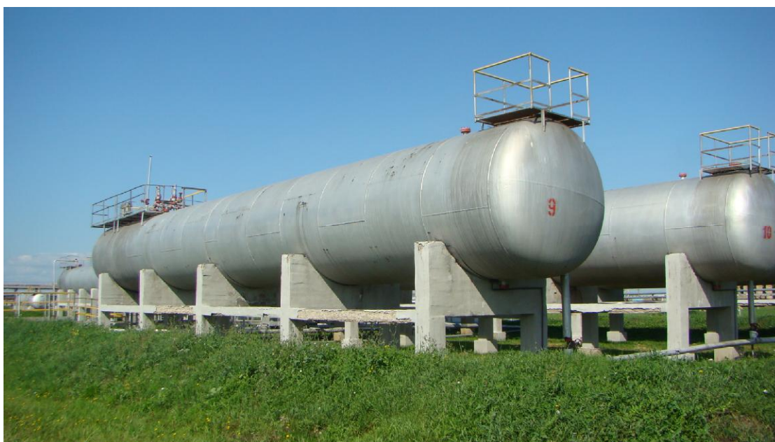
Рисунок 1 - Общий вид резервуаров стальных горизонтальных цилиндрических РГС-175
