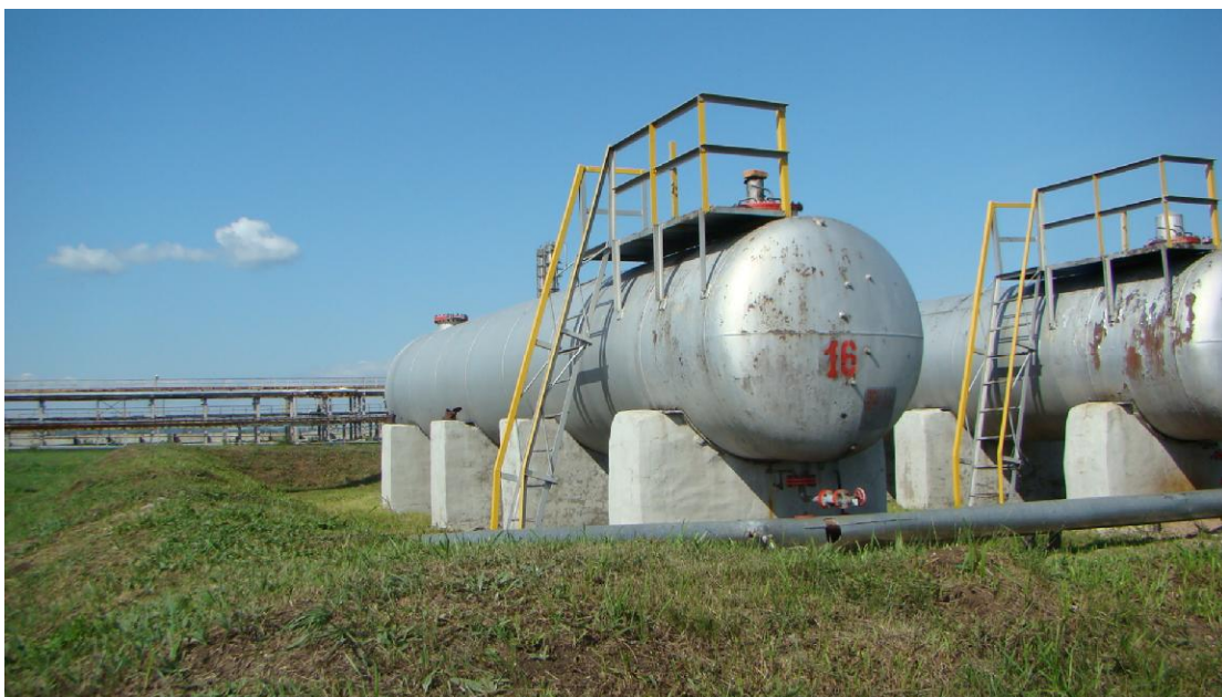
Рисунок 1 - Общий вид резервуаров стальных горизонтальных цилиндрических РГС-49
