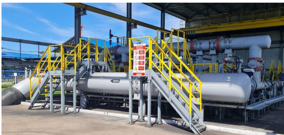
Рисунок 1 - Общий вид СИКН
