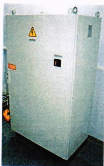
станция управления установкой
