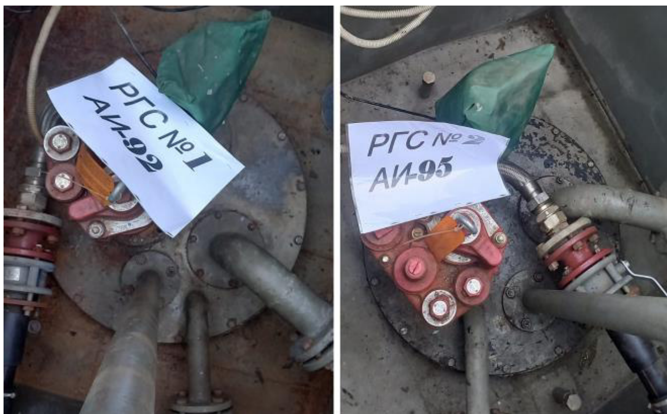
Рисунок 2 – Горловины резервуаров РГС-50 зав.№№ 1, 2
