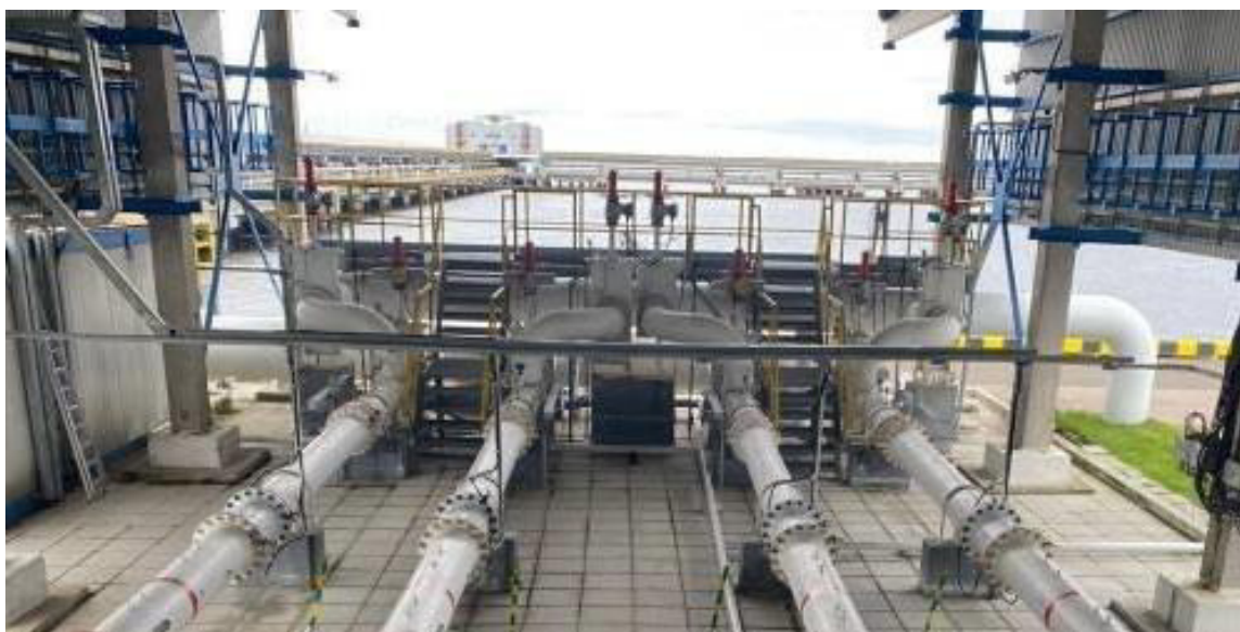
Рисунок 1 – Общий вид СИКН
