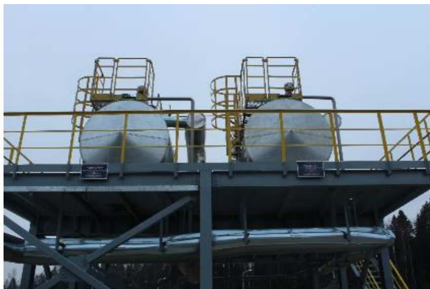
Рисунок 1 – Общий вид резервуаров РГС-20
