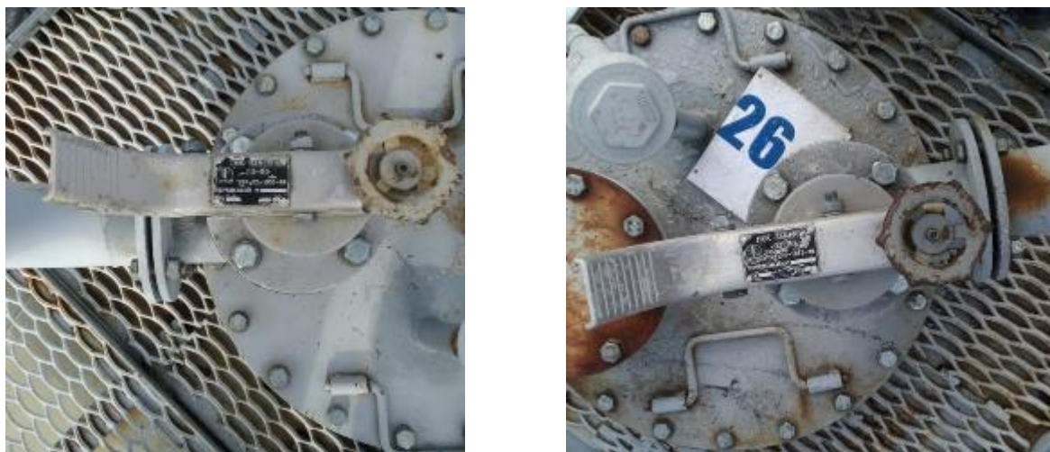
Рисунок 3 – Замерные люки резервуаров РГС-20
