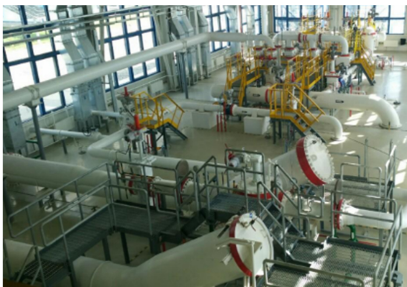
Рисунок 1 – Общий вид СИКН
