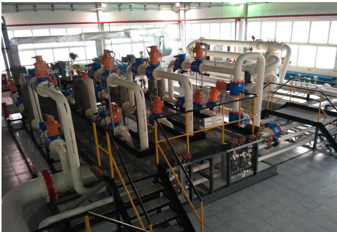
Рисунок 1 – Общий вид СИКН
