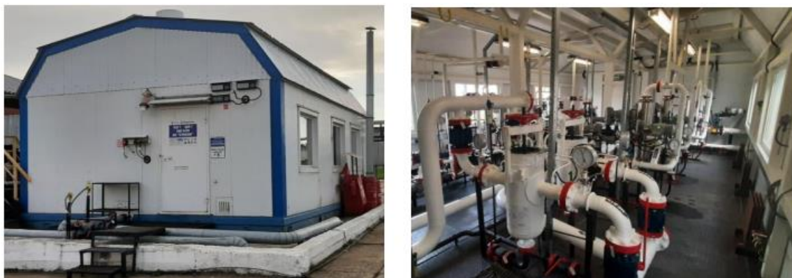
Рисунок 1 – Общий вид СИКН
