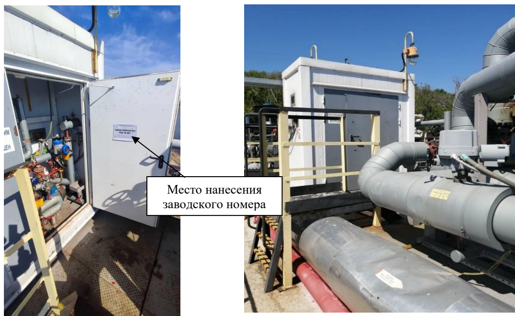
Рисунок 1 – Общий вид СИКНП с указанием места нанесения заводского номера
