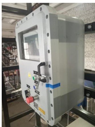
Рисунок 8 – Место нанесения пломбы на контроллер управления
