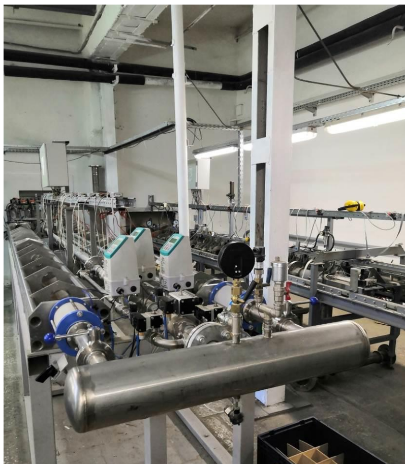
Рисунок 1 – Общий вид установки
