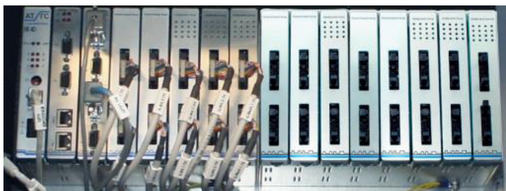
Рисунок 2 – Общий вид контроллеров с блоком расширения
