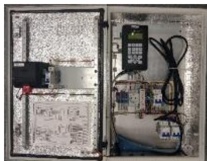
а) общий вид контроллера, смонтированного в металлическом корпусе с системой обогрева
