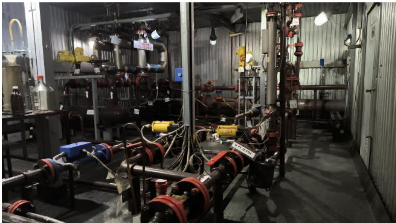
Рисунок 1 – Общий вид СИКН
