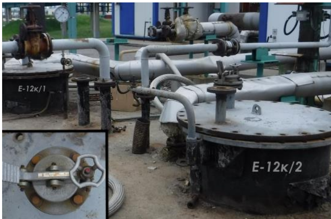
Рисунок 1 – Фотография общего вида резервуаров РГС-10, горловин и заводских номеров
