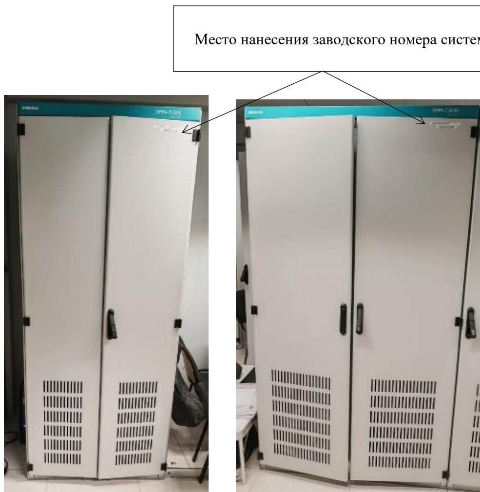
Рисунок 1 – Общий вид шкафов вторичной части системы
